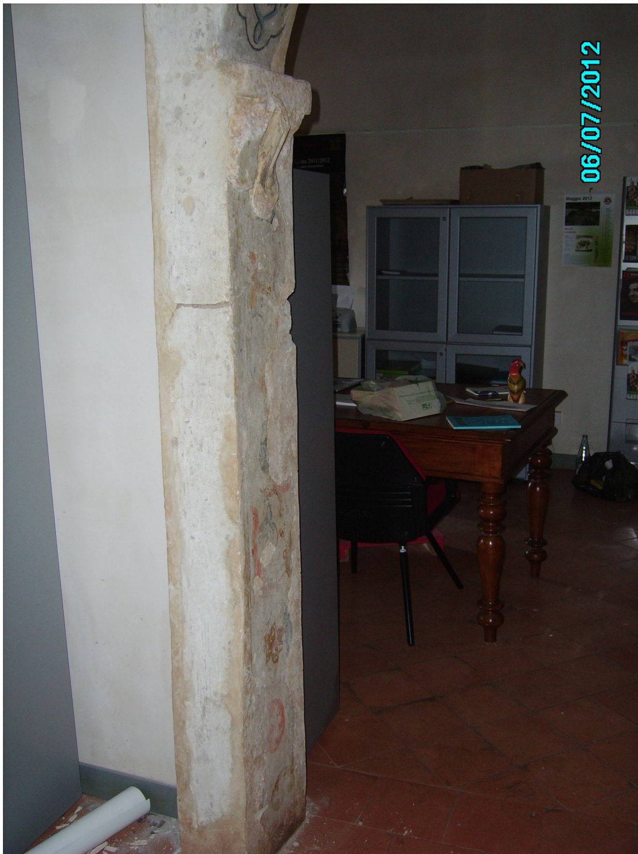
Foto 21 – lesione orizzontale su pilastro sostegno verso sud arco 1° piano lato sud
