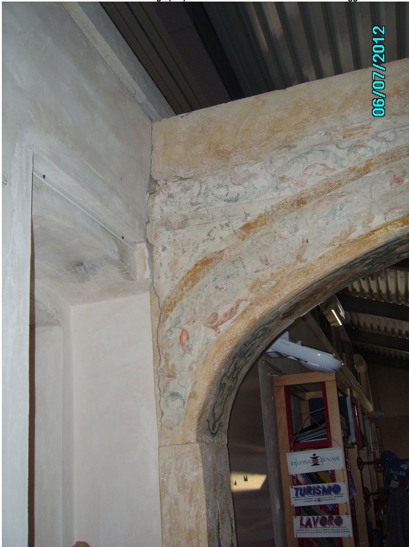
Foto 24 – arco 1° piano lato sud - distacco da muro nord – vista da ovest
