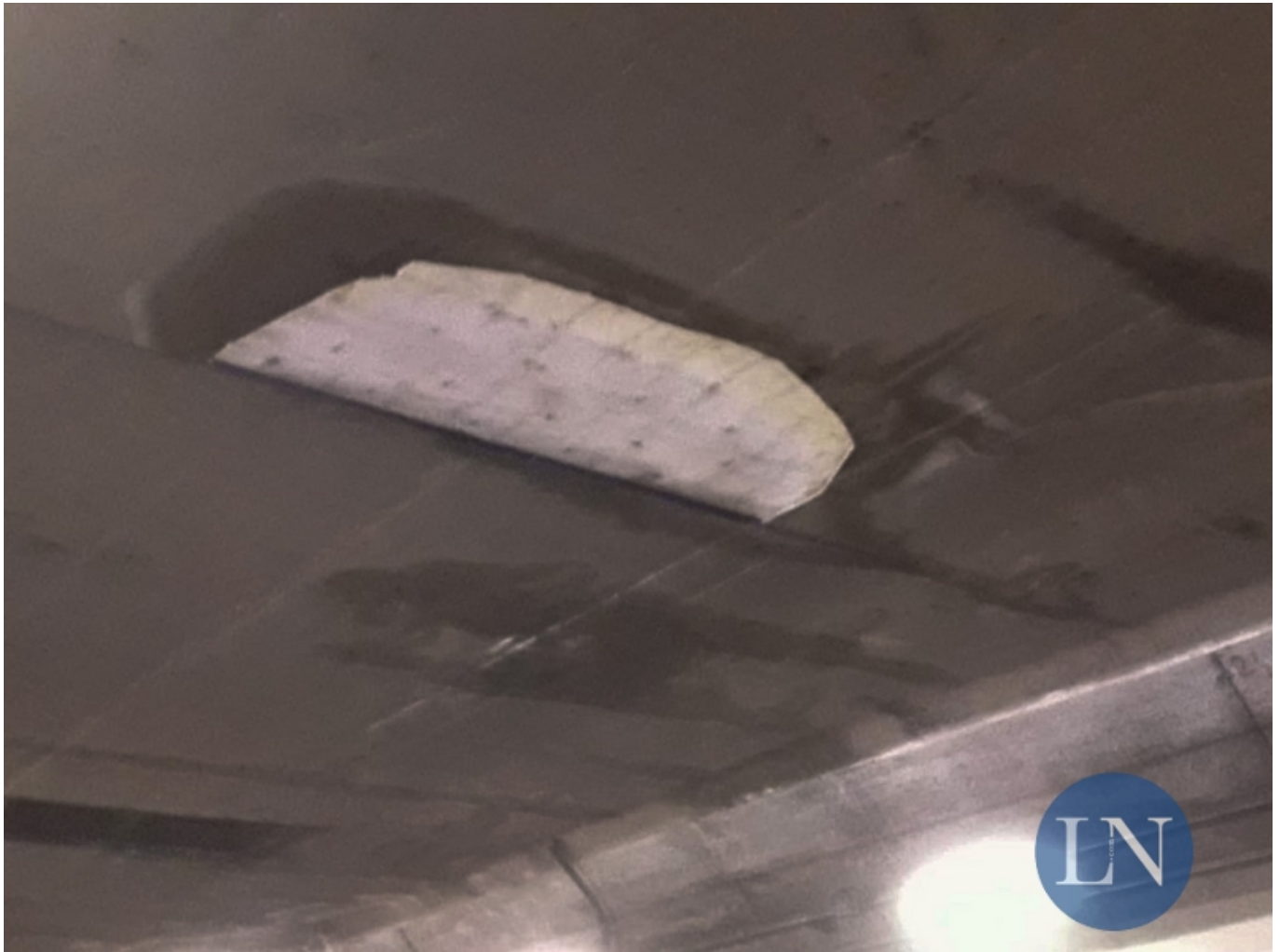
Il punto dove si è staccato il calcinaccio dal soffitto della galleria
