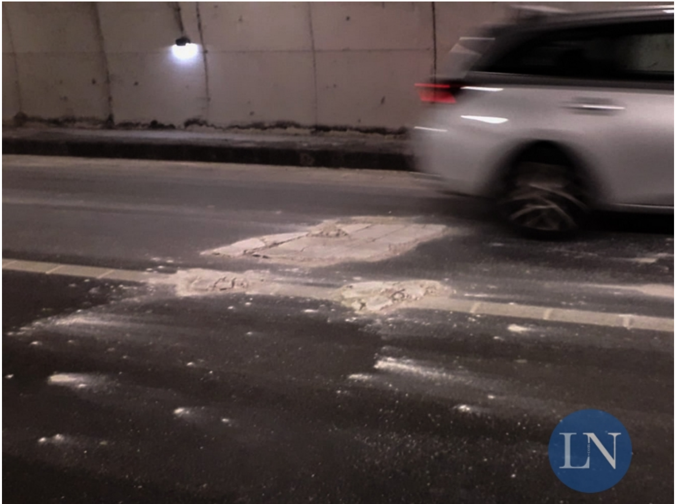
Calcinacci sull'asfalto della nuova Lecco Ballabio
