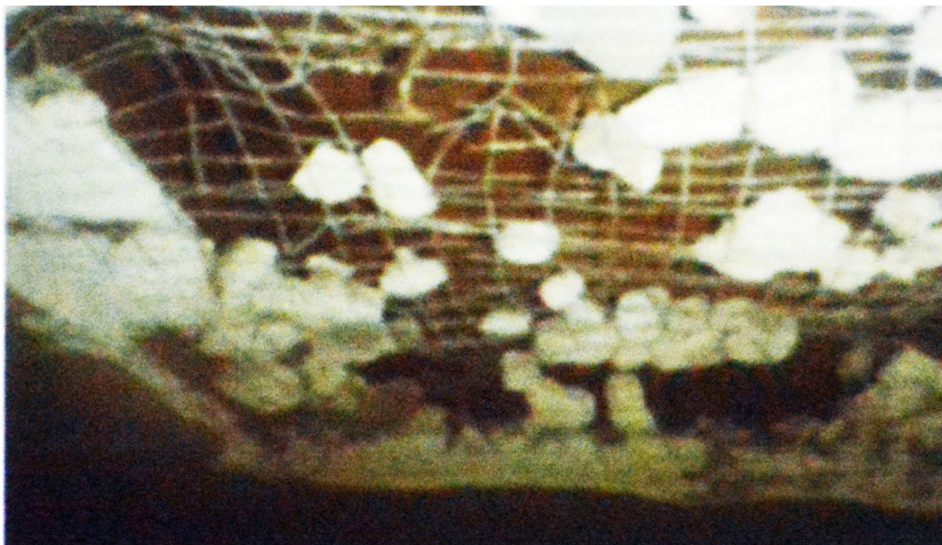
Quanto era rimasto del controsoffitto crollato alla scuola T. Grossi
