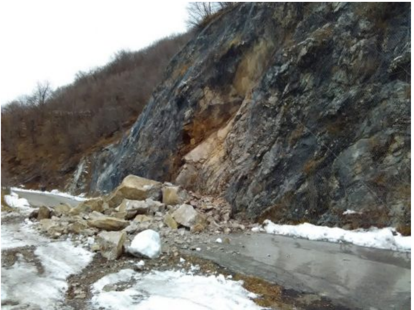
Frana sull’allora sp65 tra il bivio di Cainallo e l’abitato di Parlasco
